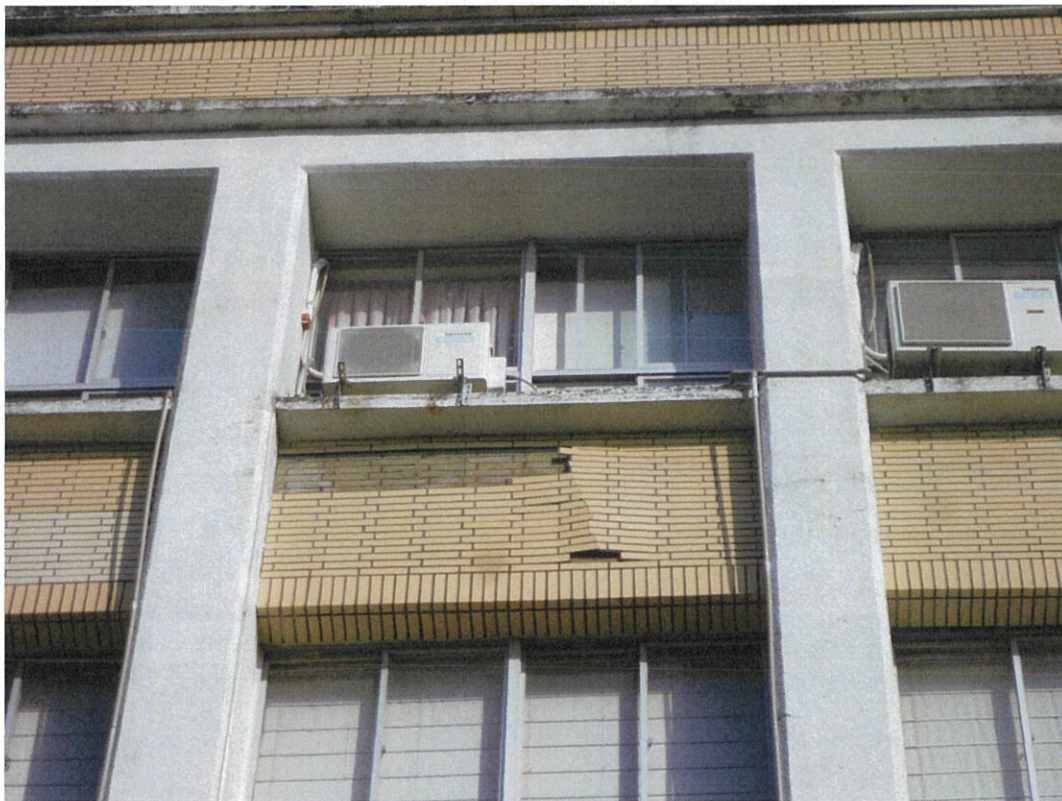
外牆磁磚膨拱掉落情形
