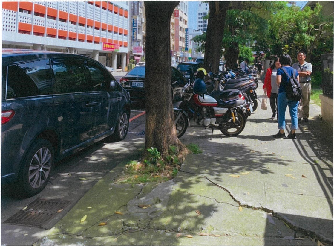
中華路人行道黑板樹及地板鋪面破損照片
