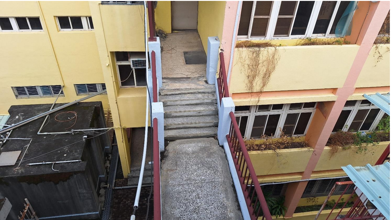
環境樓天橋 0403 花蓮地震損壞
