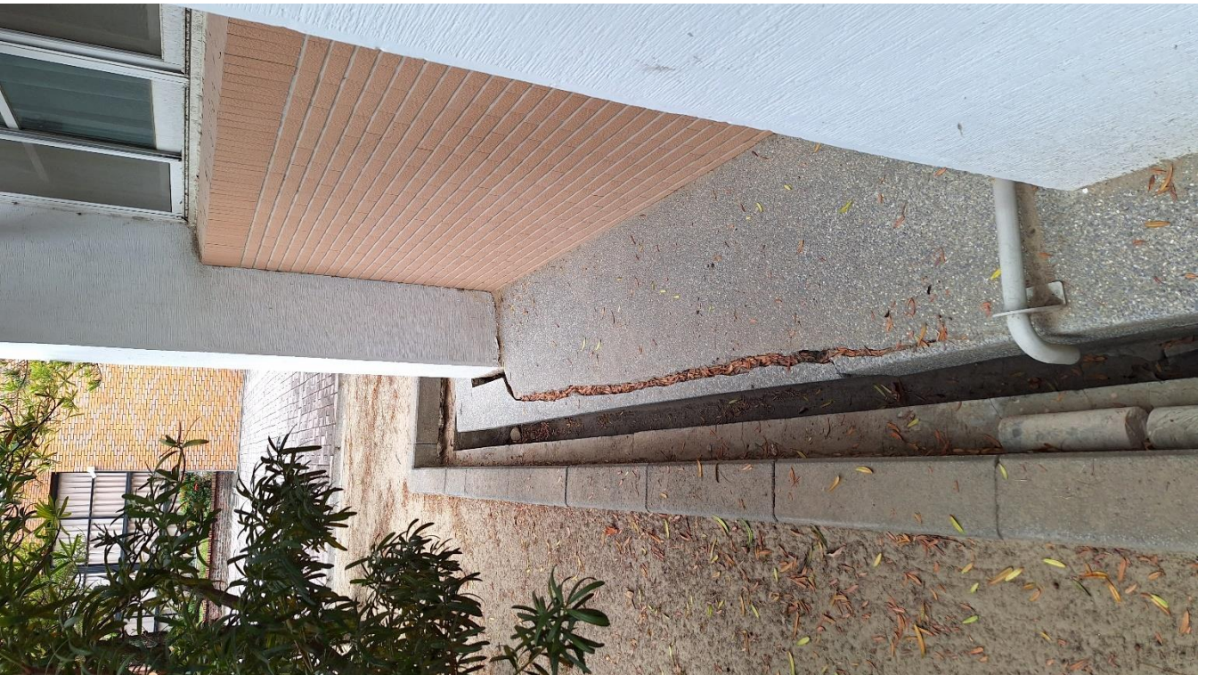
樂群樓 1 樓排水溝及犬走 0403 花蓮地震損壞
