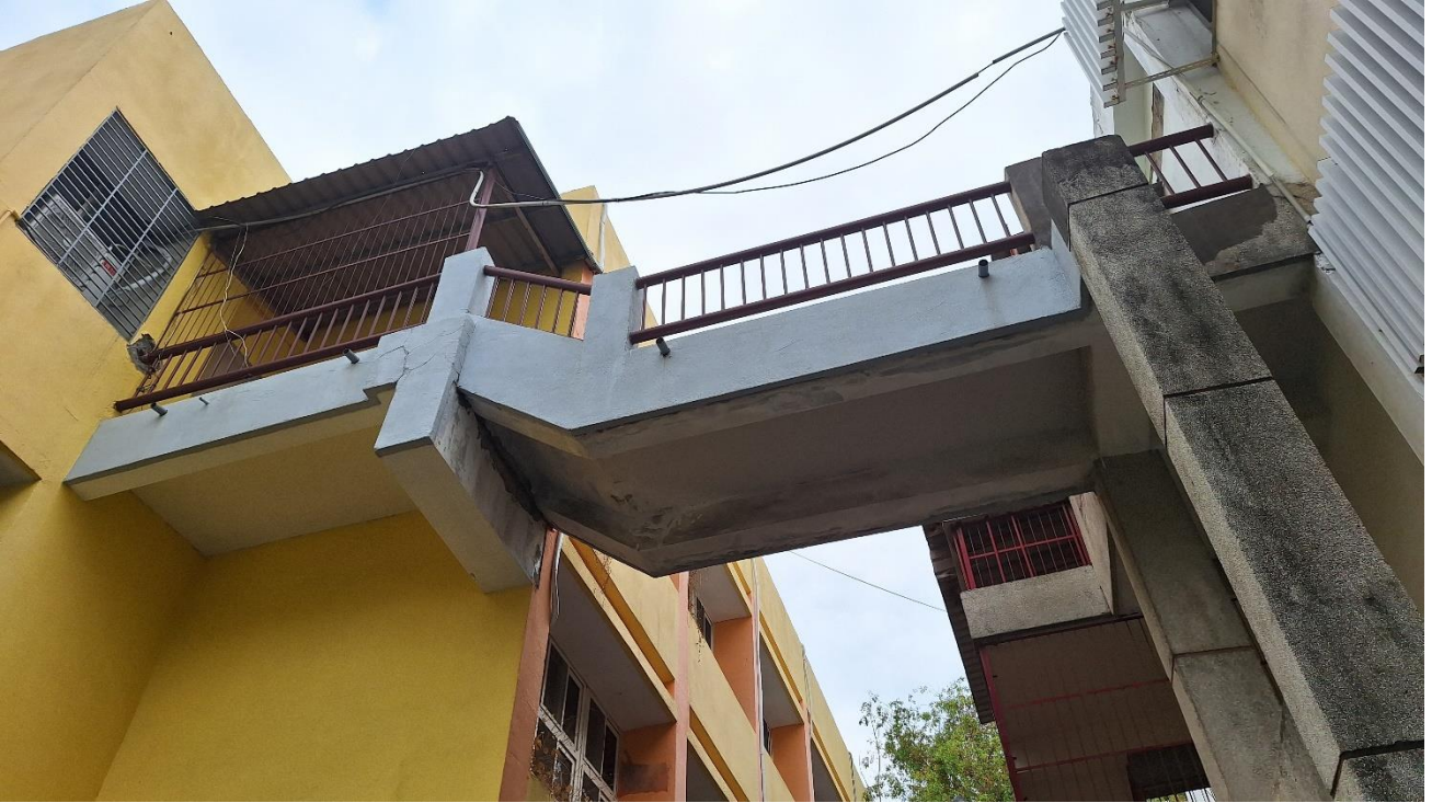
環境樓天橋 0403 花蓮地震損壞
