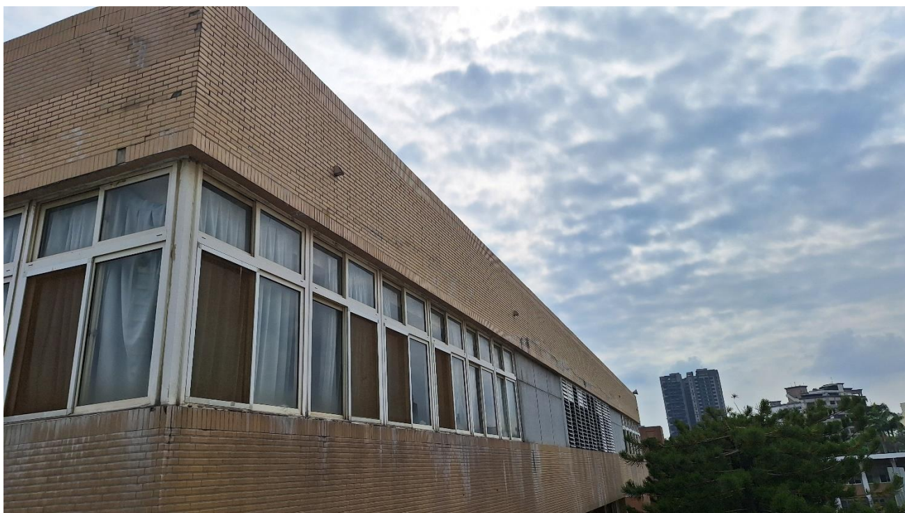
勤樸樓屋頂女兒牆、4樓外牆 0403 花蓮地震損壞
