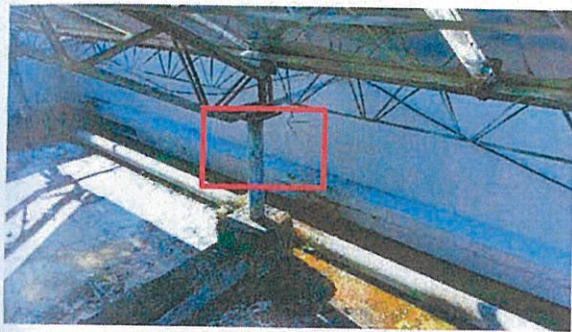
太陽能集熱器管路漏水
