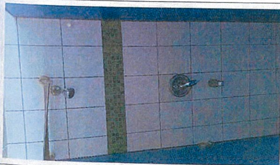
淋浴設施損壞
