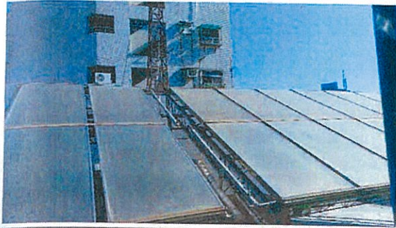
太陽能集熱器老舊、未定期清洗
