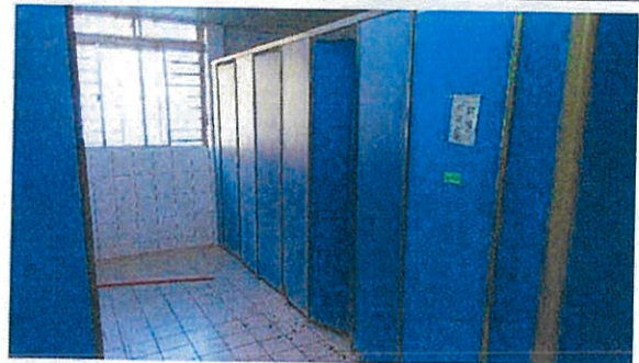
淋浴設施損壞
