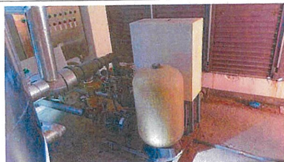
冷補水循環泵
